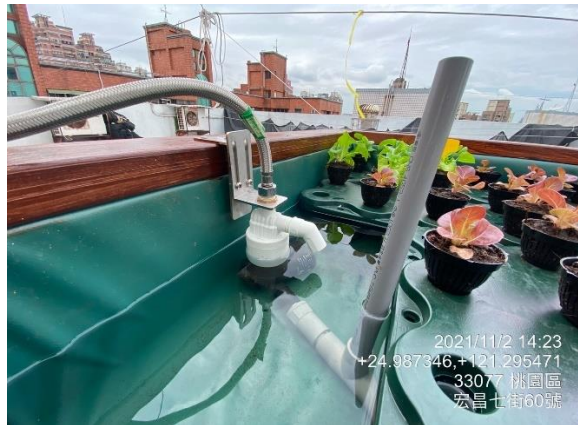
太陽能自主發電設備
