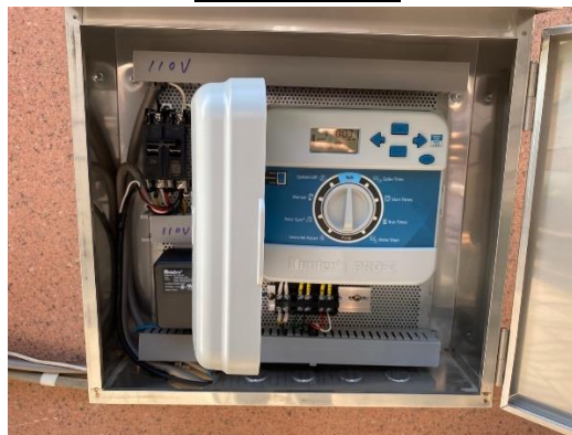
主機(微電腦)控制澆灌系統
